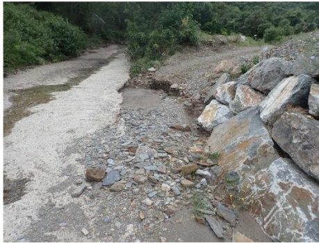
Illustration 12 : Gué endommagé, départ de sol au droit de la plateforme Marty
