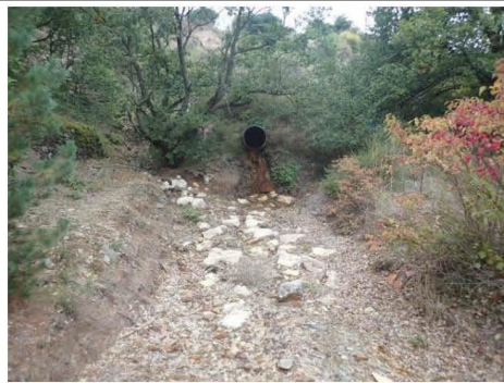
Illustration 39 : Vue de la canalisation principale en amont du bassin
