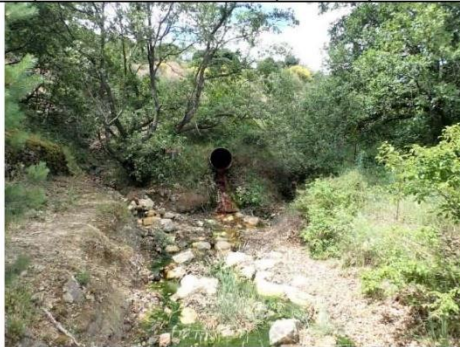
Illustration 38 : Vue de la canalisation principale en amont du bassin
