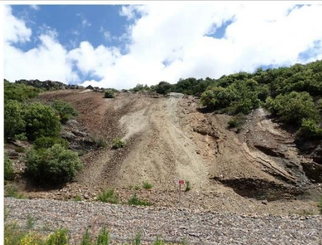
Illustration 16 : Vue générale de la verse et sa protection du pied de verse en gabions
