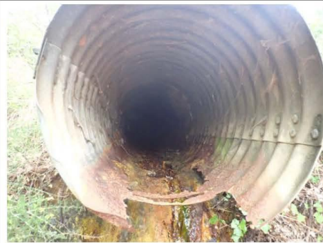
Illustration 40 : Canalisation corrodée, précipités ferrugineux en partie basse
