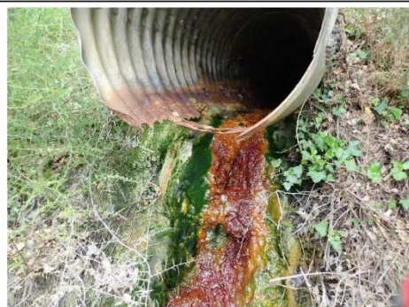
Illustration 39 : Canalisation corrodée, précipités ferrugineux en partie basse
